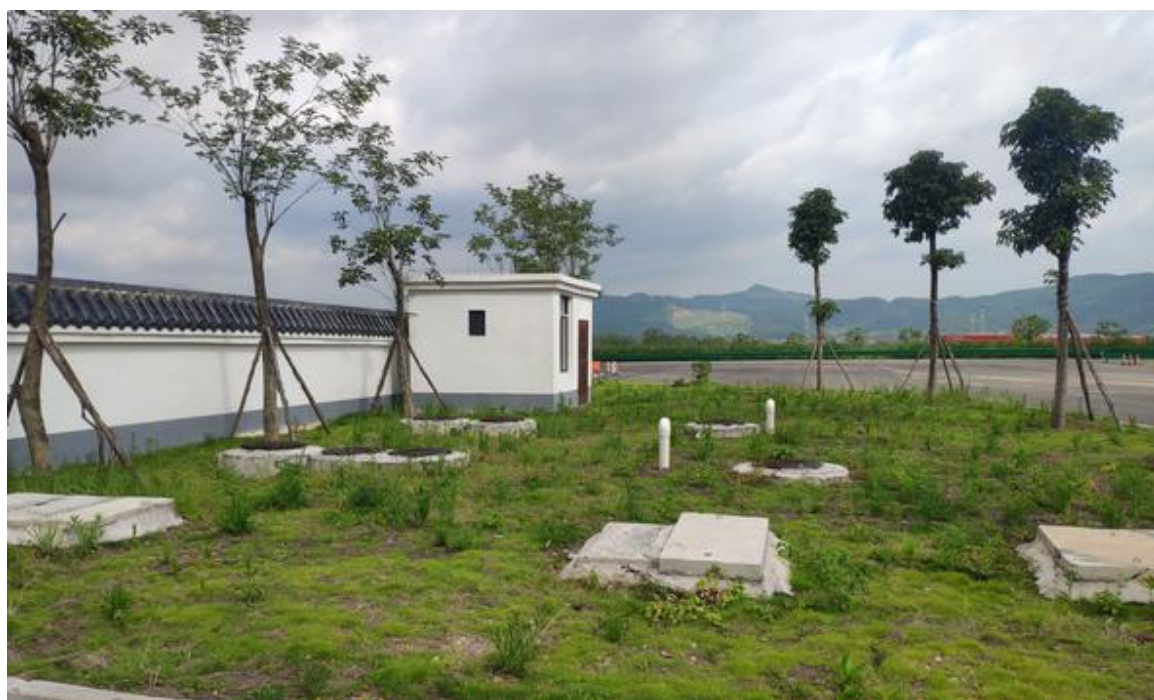
服务设施已设置的地理式污水处理设施照片
